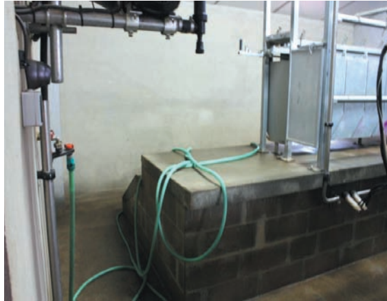
TOMA DE AGUA A LA ENTRADA DE LA SALA DE ORDEÑO
