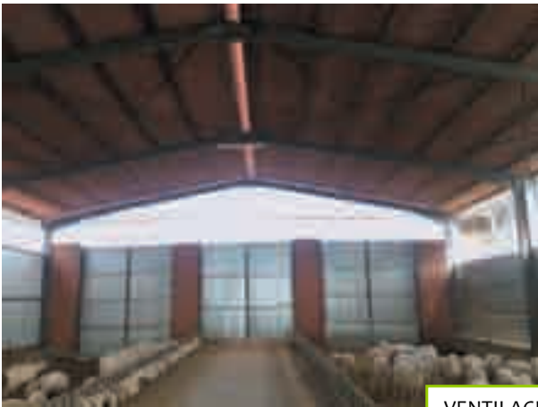
VENTILACIÓN E ILUMINACIÓN
